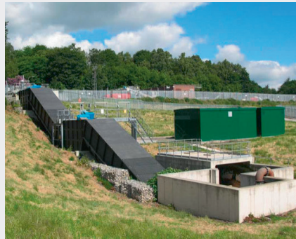
Vis hydraulique d'une STEP en Angleterre
