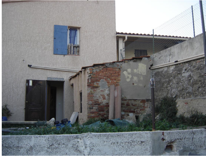
Les tuyaux de liaisons
