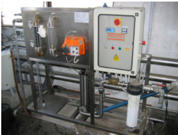
Déméralisation de l'eau par osmose (Gecam)
