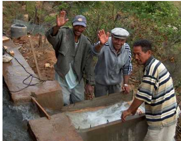
L'installation de la Pico+ est réalisée avec les bénéficiaires, qui sont ainsi capables de s'approprier rapidement la technologie.
