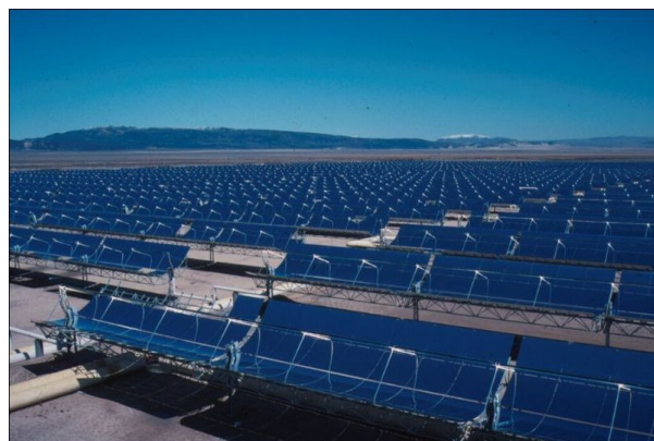
Champ de capteurs cylindro-paraboliques des centrales solaires à Kramer Junction (SEGS), Californie.
