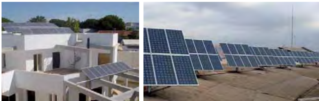
Ilustración 1.2. Instalaciones fotovoltaicas de conexión a la red (vivienda particular y planta comercial).
