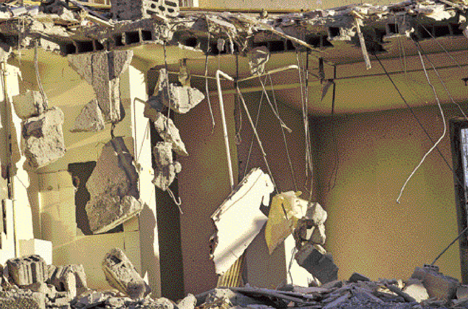
Les déchets de demolition des isolations de façades peuvent receler des ignifugeants.
