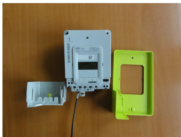
Figure 5 : compteur Linky ouvert faisant apparaître le bornier
